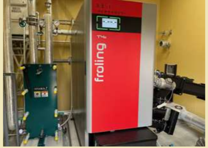
↑チップボイラー本体
