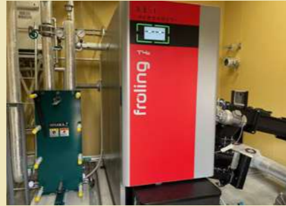
↑チップボイラー本体
