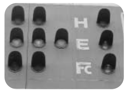
【上】割られたスコアボード。特殊な器具のため6月中旬まで使用不能 【右】電気の配線が切れ火花が差し込まれていました。
