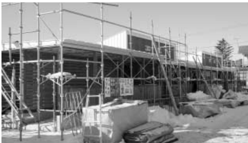
建設中の特公賃住宅。最新設備のオール電化が特徴です
