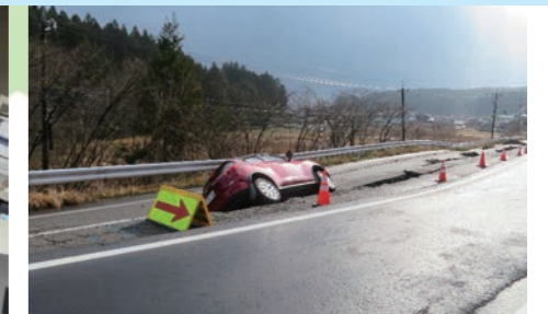
穴水町内の道路が、いたるところで隆起し寸断している
