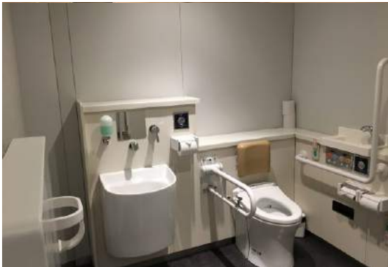
オストメイト対応多目的トイレ
