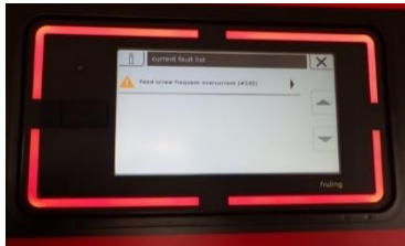
ボイラー側のエラー表示
