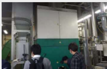
生チップボイラー「エコモス」
