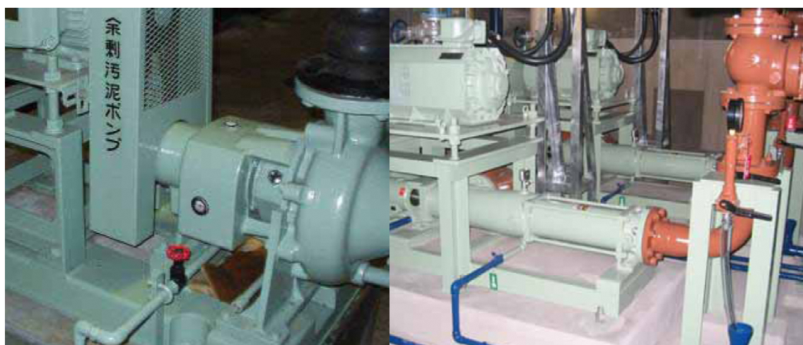
図 6-4 公共下水道処理場施設（機械設備例）
