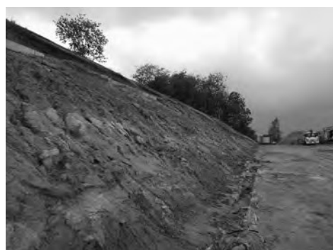
一般廃棄物最終処分場の崩壊した法面
