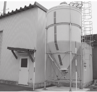
役場横 ペレットボイラー施設
